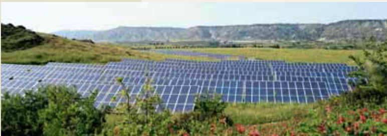
Solaranlage in Italien: Q-Cells ist ein führender Photovoltaik-Systemanbieter.
